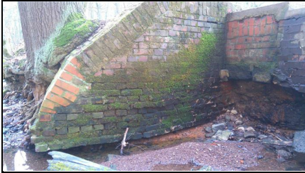
Abb. 3: Unterspülte Mauer am Ablaufbauwerk, 19.02.2019
